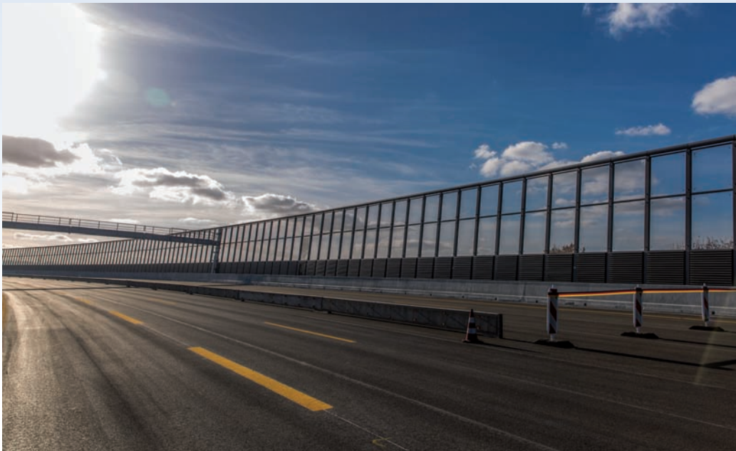
Sensible Bereiche unserer Verkehrsinfrastruktur fordern von den installierten Fahrzeug-Rückhaltesystemen maximale Sicherheit mit ausreichenden Reserven. Die Systeme werden wie hier auf der Langenfelder Brücke auf der A 7 ausgewählt, um den bestmöglichen Schutz für alle aktiven und passiven Verkehrsteilnehmer sowie für die im unmittelbaren Umfeld installierte Infrastruktur zu gewährleisten
