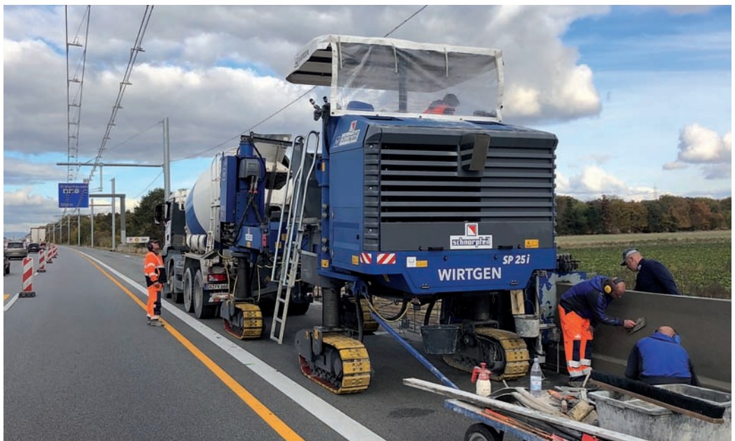
Bild 1: Die Betonschutzwand schützt die Masten, an denen die Oberleitung befestigt ist, vor einem Anprall (Fotos: Schnorfeil Bau)
